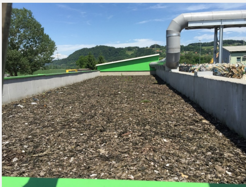
Slika 12 Biofilter – druga faza prečišćavanja vazduha pre ispusta u okolinu
