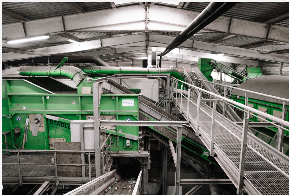
Slika 10 Tehnološka oprema Centra za upravljanje otpadom „Ranlevo“
